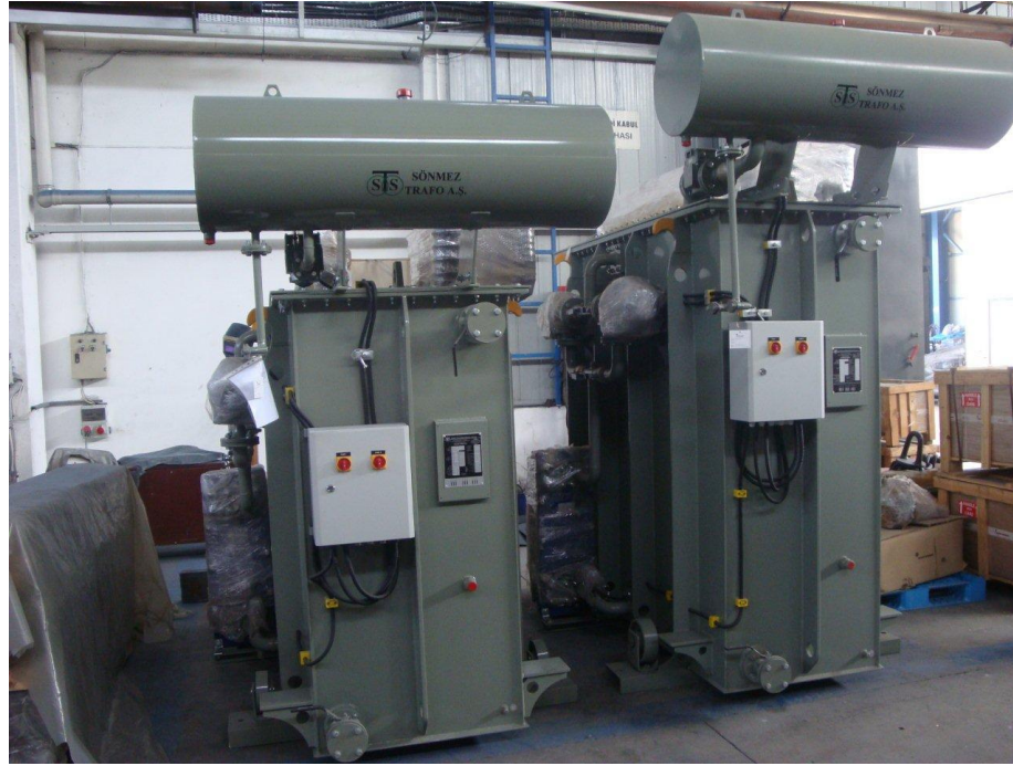
Şekil- 4 Radyatörsüz su soğutmalı trafolar
